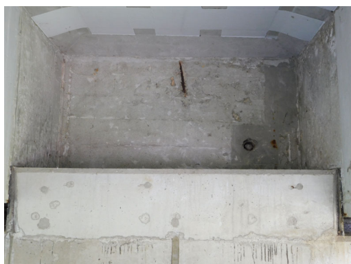
写真 3-1 中性化による損傷状況 (目屋橋・横桁)
