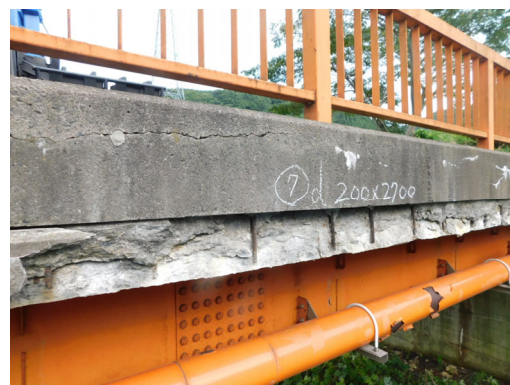
写真 3-2 凍害による損傷状況 (川辺橋・コンクリート床版)
