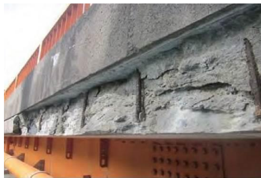
写真 3-2 凍害による損傷状況 (川辺橋・地覆)
