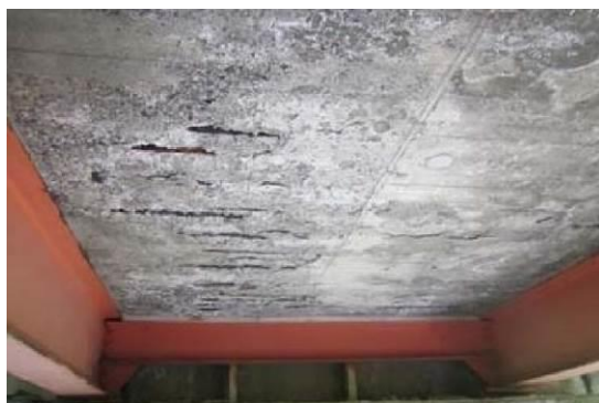
写真 3-1 中性化による損傷状況 (第2目屋橋・床版)
